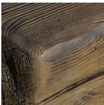
OŠLAPANÉ HRANY A ROHY
